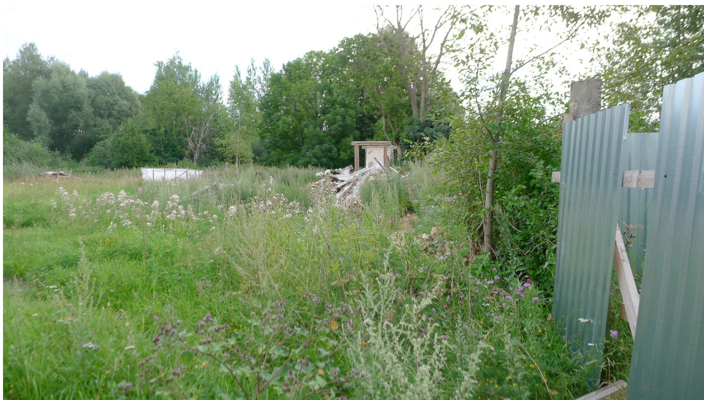
Фото 2. Вид остатков разрушенного главного корпуса «Почтовой станции».
